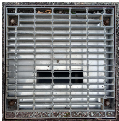
設置されたフラップ式防臭装置(設置当時)
